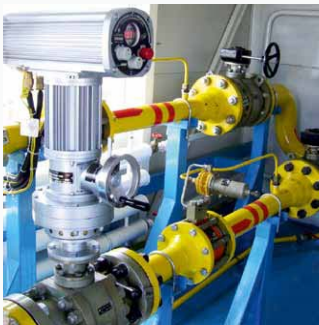
Рис.5. Поворотный электропривод РэмТЭК-02.П.250, Блок редуцирования газа, площадка Боатасино
