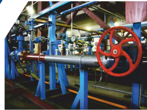
Блок входных ниток Ярактинского н.г.к.м. ООО «Иркутская нефтяная компания»
