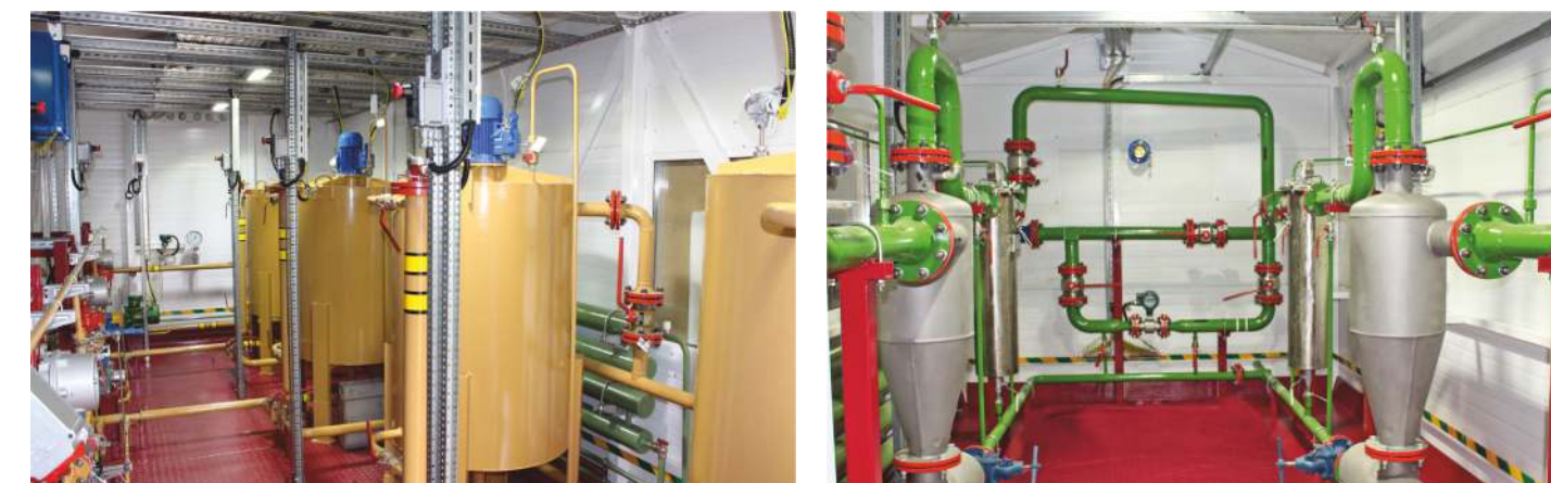
Растворно-солевой узел для Казанского нефтегазоконденсатного месторождения ОАО «Томскгазпром»
