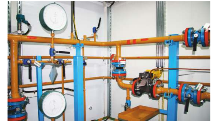
БИК нефти на выходе ПСП «Игол» ОАО «Центрсибнефтепровод»
