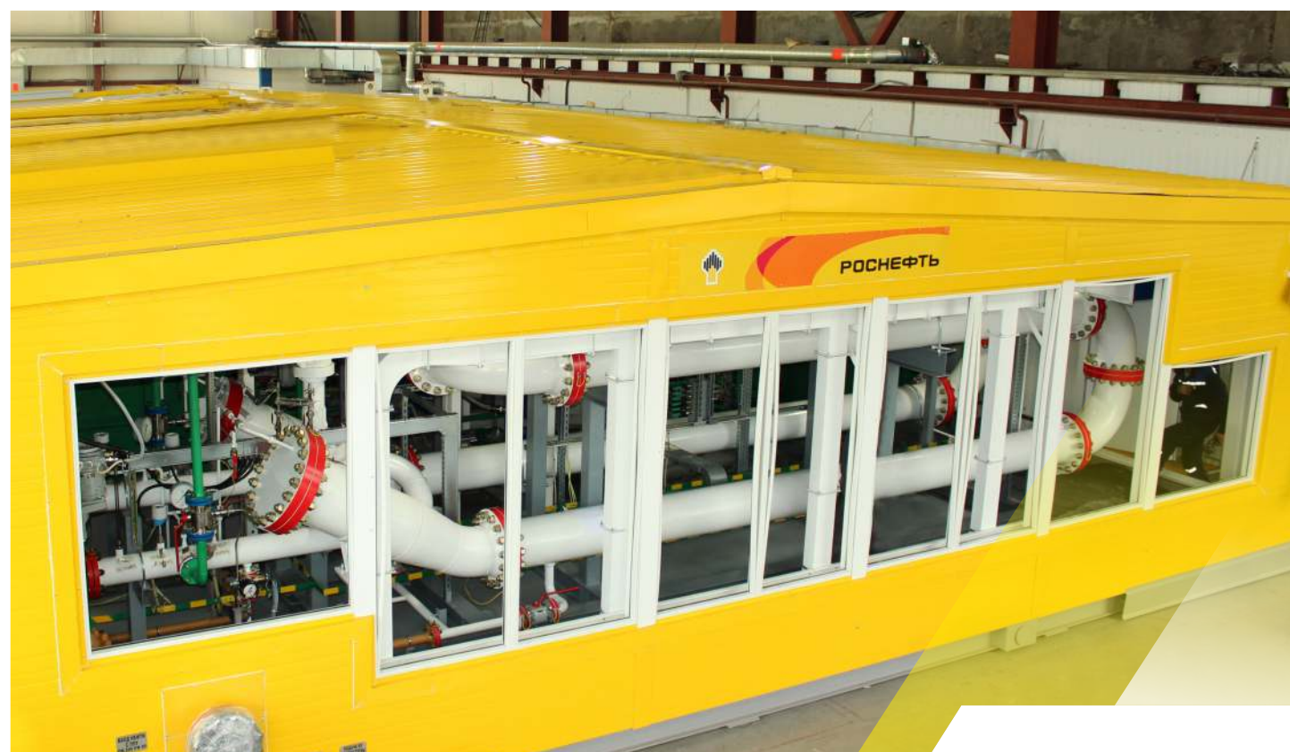
СИКН ПСП «Юрубчен». ПАО «Востсибнефтегаз»
