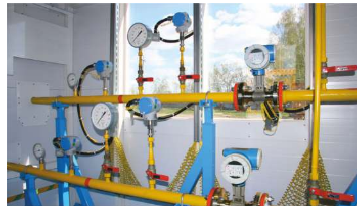
СИКГ КС №2 ЦПС-ДНС-3 Барсуковского месторождения ООО «РН-Пурнефтегаз»
