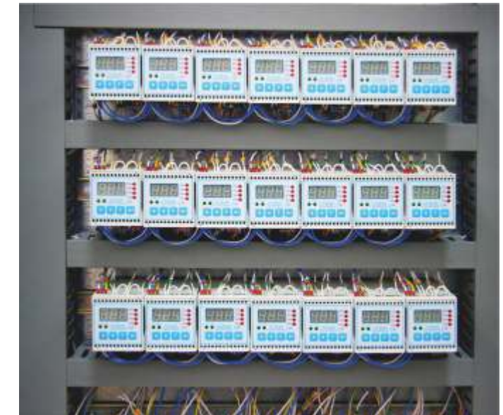
Система контроля загазованности на базе газоанализаторов ГСМ-05
