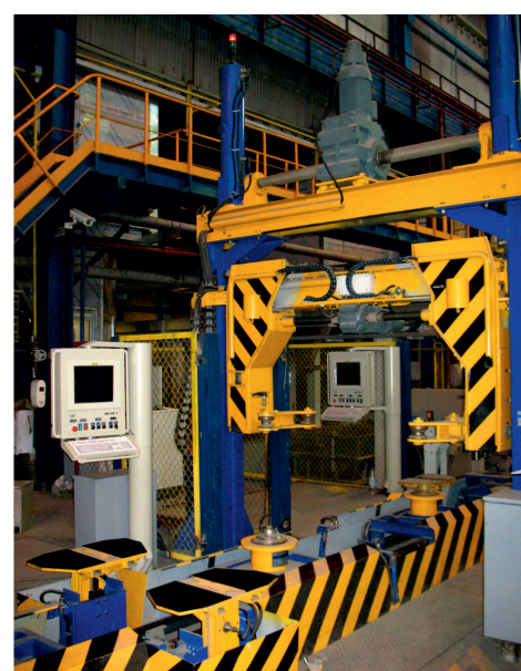
Автоматизированная линия выходного контроля (ЛВК) железнодорожных колес колесобандажного цеха ОАО «НТМК»
